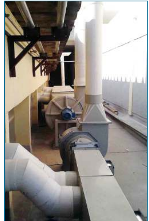
Sistemas de Exaustão
